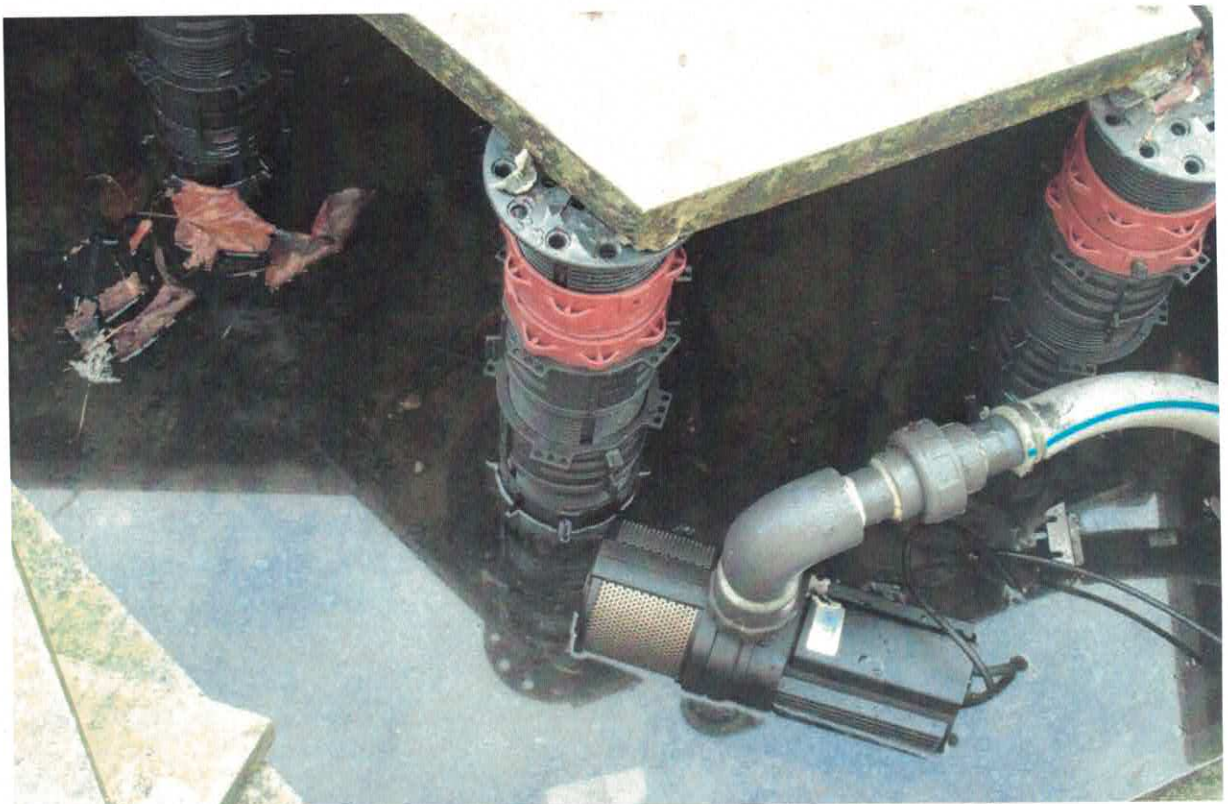
Fot. 07 Fontanna – uszkodzona instalacja hydrauliczna
