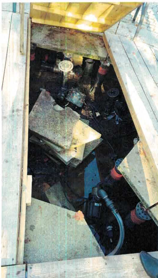
Fot. 01 Fontanna – widok ogólny (widoczne uszkodzone elementy granitowe płyty głównej oraz uszkodzona instalacja)
