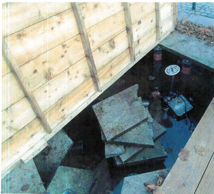
Fot. 08 Fontanna – Widok ogólny z widocznym chodnikiem i nieuszkodzonym skrajnym elementem plyty fontanny, co świadczy o prawidłowym przyjęciu podpór elementów kamiennych
