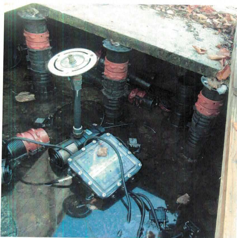
Fot. 05 Fontanna – widok instalacji przy elemencie granitowym F (dysza z zasilaniem zostały przesunięte podczas wyciągania samochodu z niecki)
